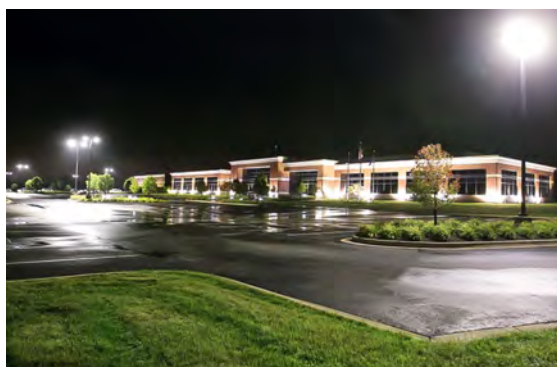
éclairage des parkings
